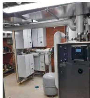
Säätölaitteet tulivat nykyaikaisiksi.
